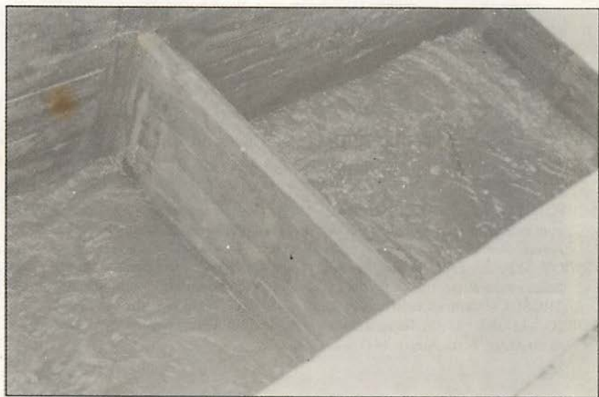
Fig. 5 – Dois tanques com reduzida quantidade de água e os tabiques quase emersos totalmente.
