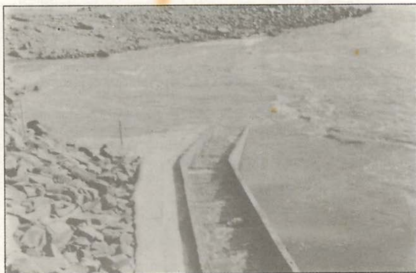
Fig. 2 – Escadaria da Barragem de Dom Marco. Dique de aterro e pedras, e turbilhona- mento das águas.
